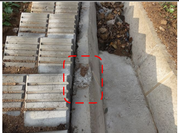
52.94K 산마루측구 파손
