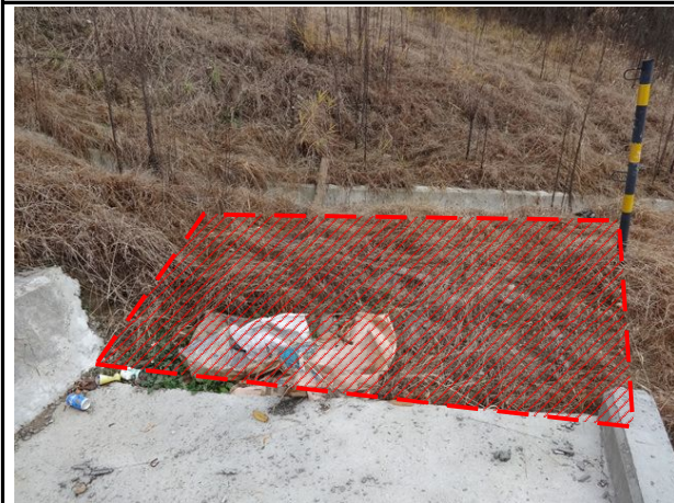
53.07K 1소단배수로~산마루측구 이음부 미설치
